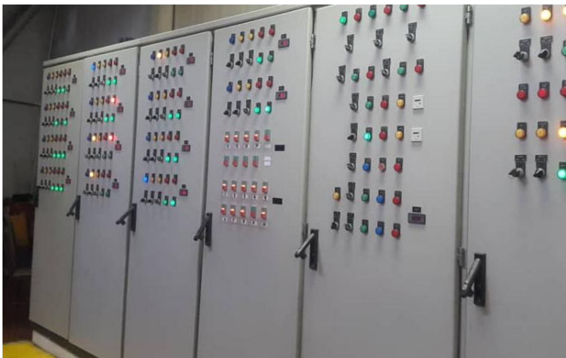
یک سیستم تعیین دمای محیط سردخانه
