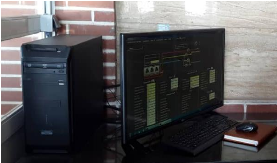
یک سیستم ثبت دمای سردخانه اتوماسیونی متصل به حسگرهای درون محفظه ضدعفونی
